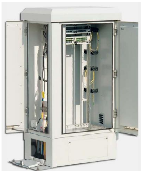
Rysunek 6. Szafa kablowa
